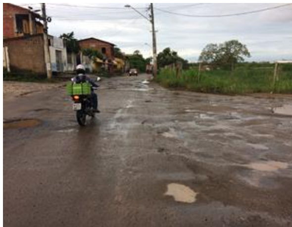
Figura 03.01- Ausência de drenagem e deformações no pavimento da Av. Dionísio Leonel Alencar (Fonte: SEINF, Abril/19)
