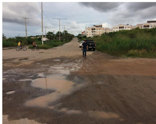
Figura 03.04 – Ausência de drenagem e calçadas da Av. Dionísio Leonel Alencar (Fonte: SEINF, Abril/19)
